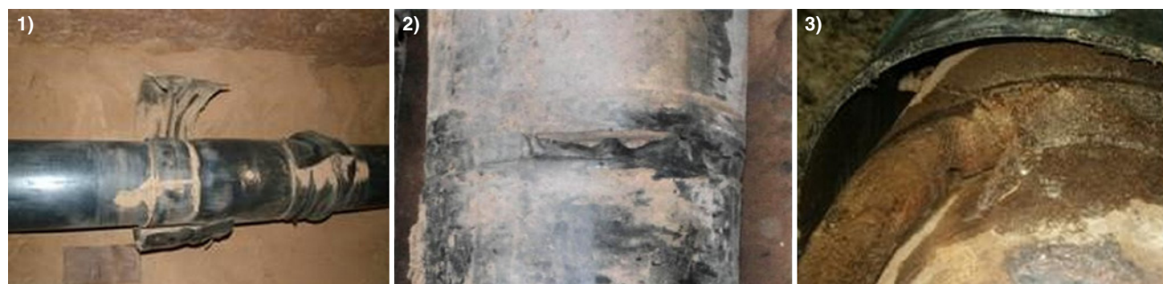
Рис. 1. Дефекты: 1) некачественная заделка стыка труб в ППУ-изоляции; 2) сдвиг и нарушение герметичности термоусадочного банджа в местах стыков трубы; 3) проникновение грунтовых вод в местах нарушения сплошности наружной гидроизоляции, приведшее к «сжеживанию» ППУ и его отслоению. Изменение структуры ППУ сопровождается отслоением его как от внутренней поверхности защитной полиэтиленовой трубы, так и от наружной (более значимо!) поверхности металлической трубы
